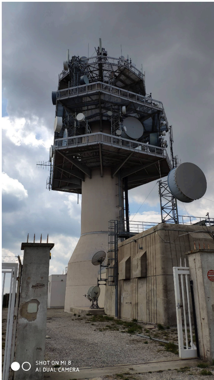
Figure 4 - Antennes de Faisceau Hertzien
