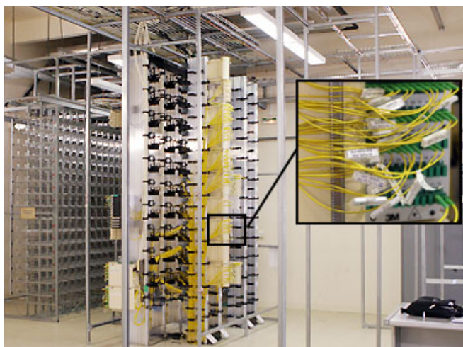
Figure 7 - Photo d'un répartiteur optique
